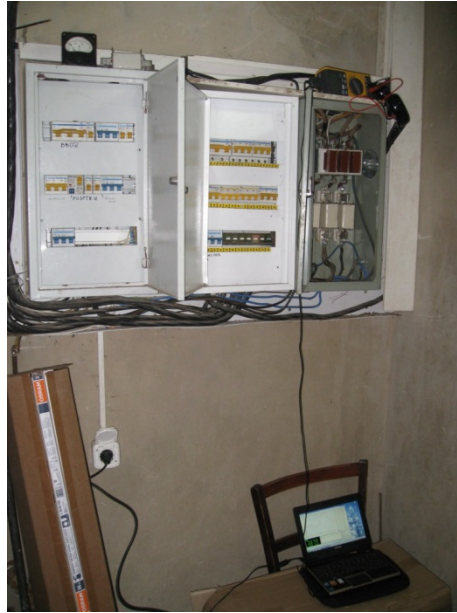
Рис.1. Дослідна установка в щитовій корівника
