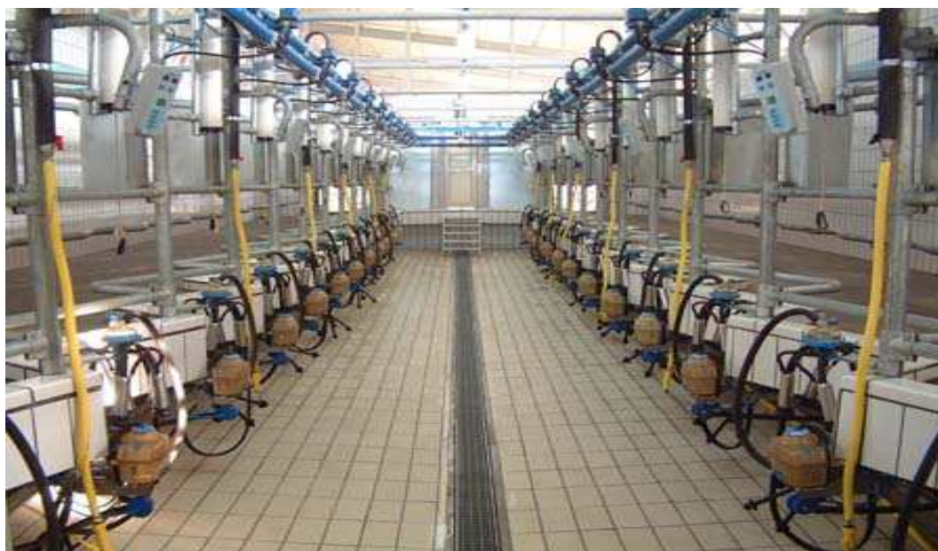
Рис. 2. Доїльна установка «Ялинка»
